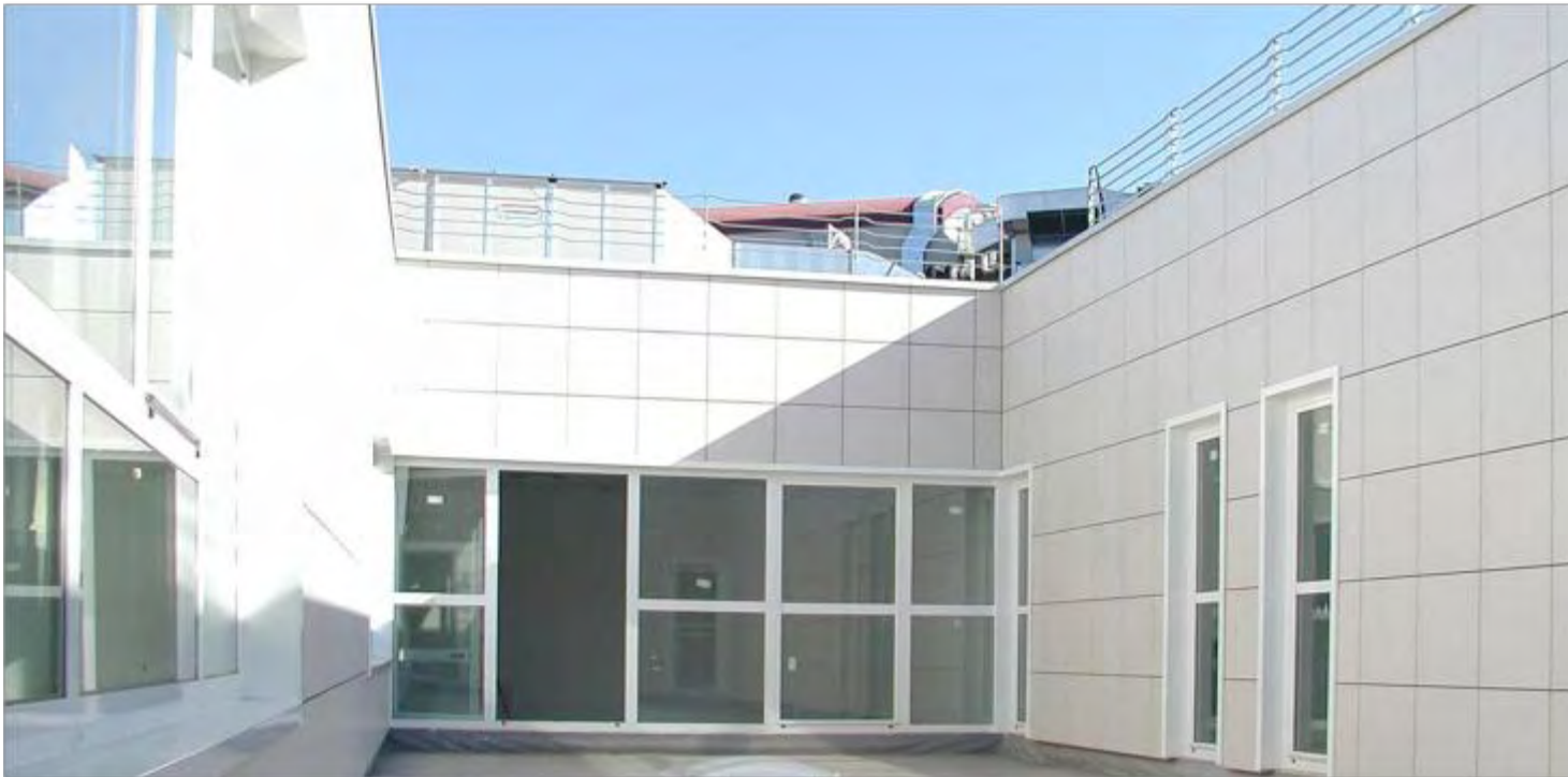
56 | 57 - tranche A vues du patio de la présidence en construction et réalisé
